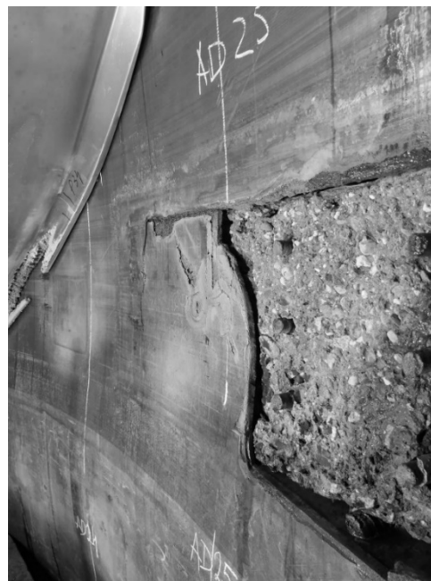
Fig. 3 Coroziune a învelitoarei metalice a peretelui Fig. 3 Corrosion of the metal cover of the wall
